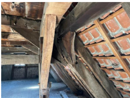
Zerstörter Verbindungsknoten (Kehlriegel/Sparren) mit nachträglich eingebrachter Unterstützung
