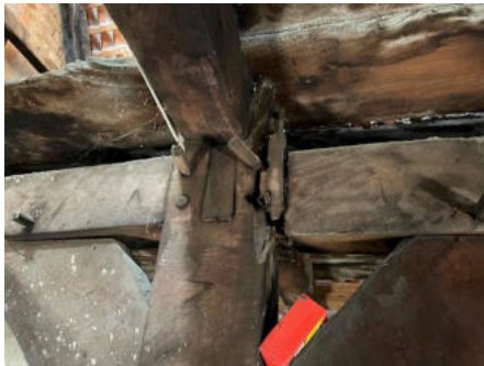
Zerstörte Zapfenverbindung (Mittelriegel)
