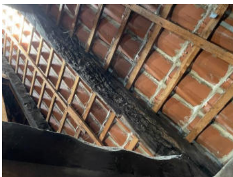
Querschnittsschwächung des Kehltriegels und vermutlich durch Brandeinwirkung geschädigter Sparren
